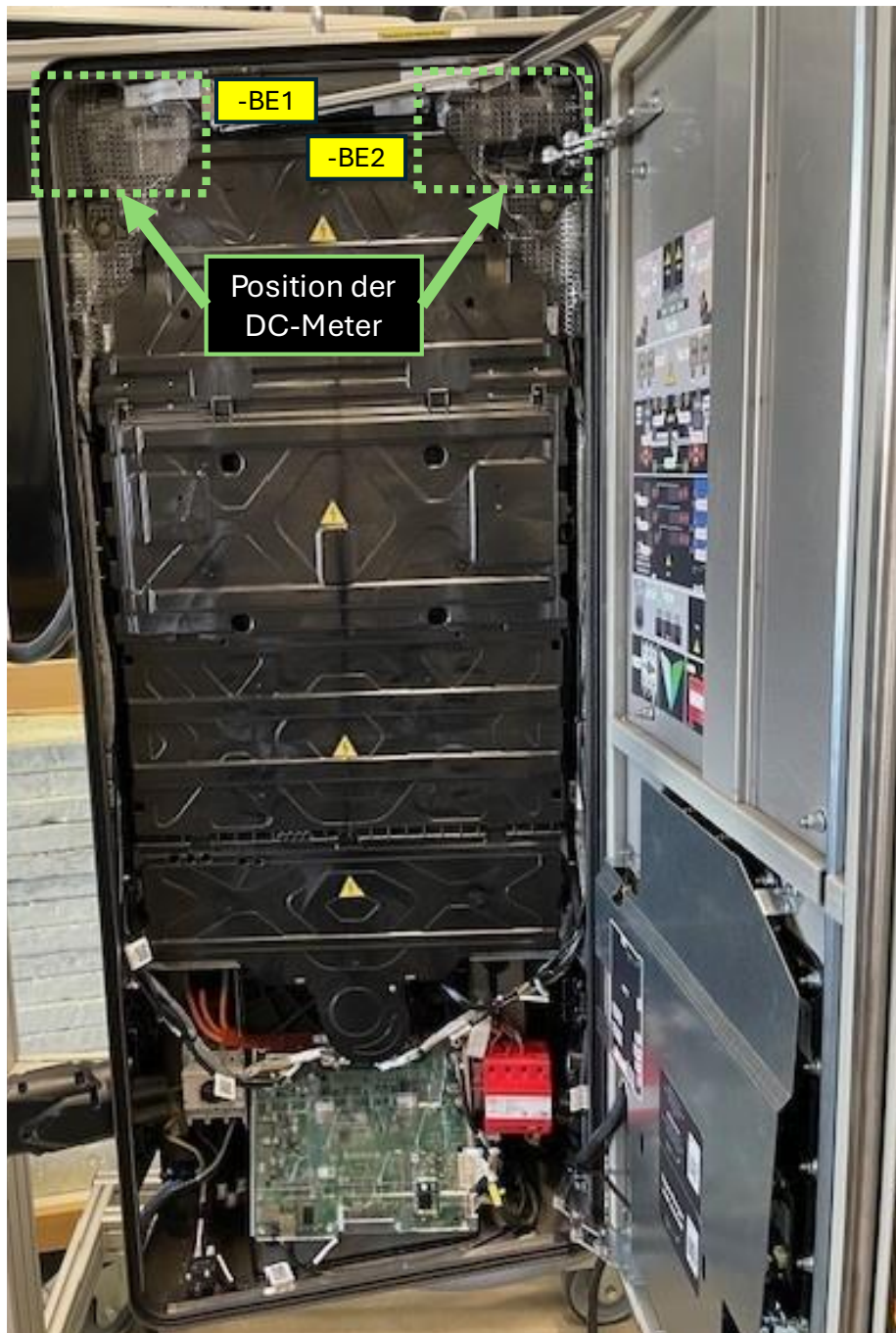
Abbildung 6: Position DC-Meter in Säule
